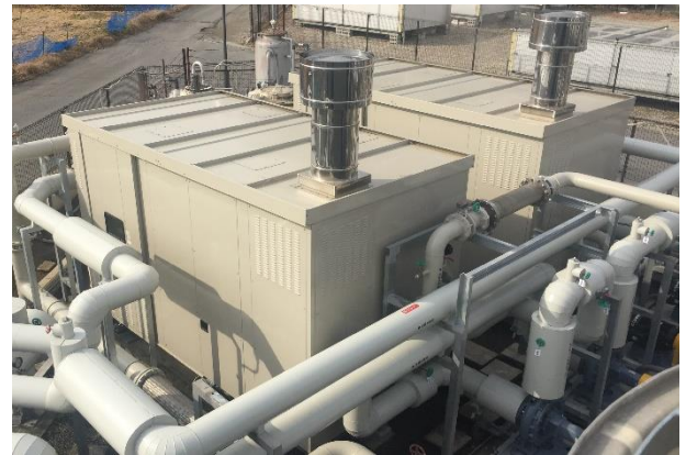
<高効率空調システム>
