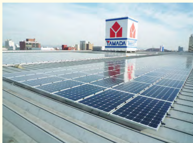
ヤマダ電機さまは太陽光パネル設置店舗の拡大を推進されています。
