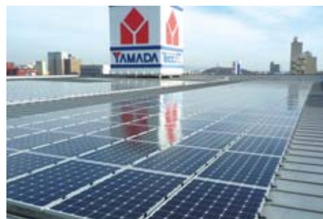
店舗の屋根に設置した太陽光発電システム
