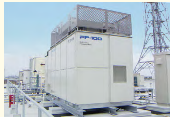
導入した燃料電池により、災害時にも安定した電力供給が可能となりました。
