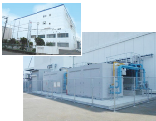
自然冷媒を使用した冷凍設備は、オゾン層保護だけでなく、地球温暖化にも配慮した設備です。
